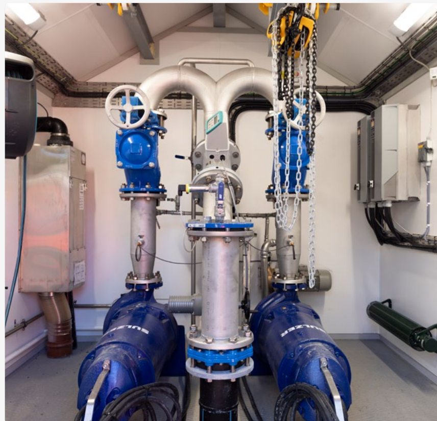
Innsida av ny kloakkpumpestasjon ved veganlegget på Moster.
