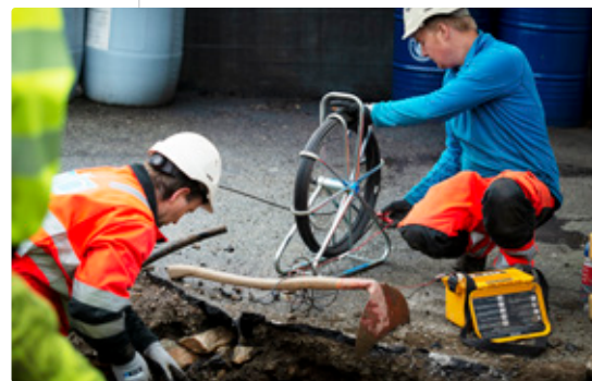
Tor Eivind Gilje og Nils Ragnar Vika har søkt seg fram til lekkasje
