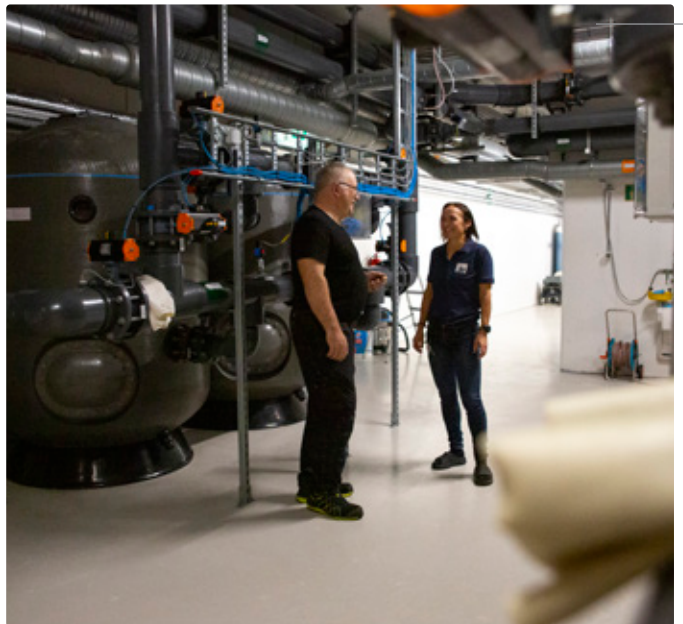
Det omfattande tekniske anlegget handterer store mengder vatn og blir følgd opp av driftsoperatør Tore Mæland.
