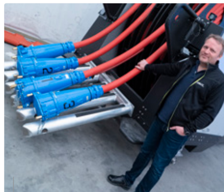
Det er kraftige dimensjonar over Shore Power Cruiser, høgspenst landstram for cruise-skip.
